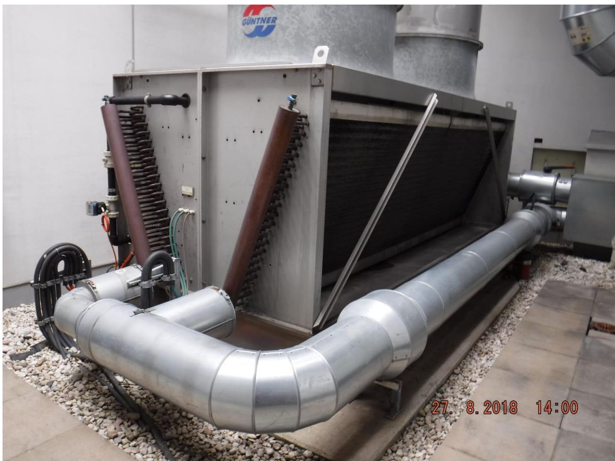
Quelle/Foto: Kleinere Verdunstungskühlanlage mit 800 kW © Dipl.-Ing. Georg Tale-Yazdi
